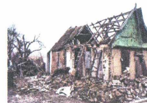
❖ Зруйновані будівлі та споруди
